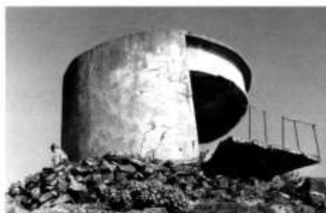
Каземат тепловепеленгаторной станции (ТПС) на о. Большой Пелис. Фото Ю. В. Иванова
